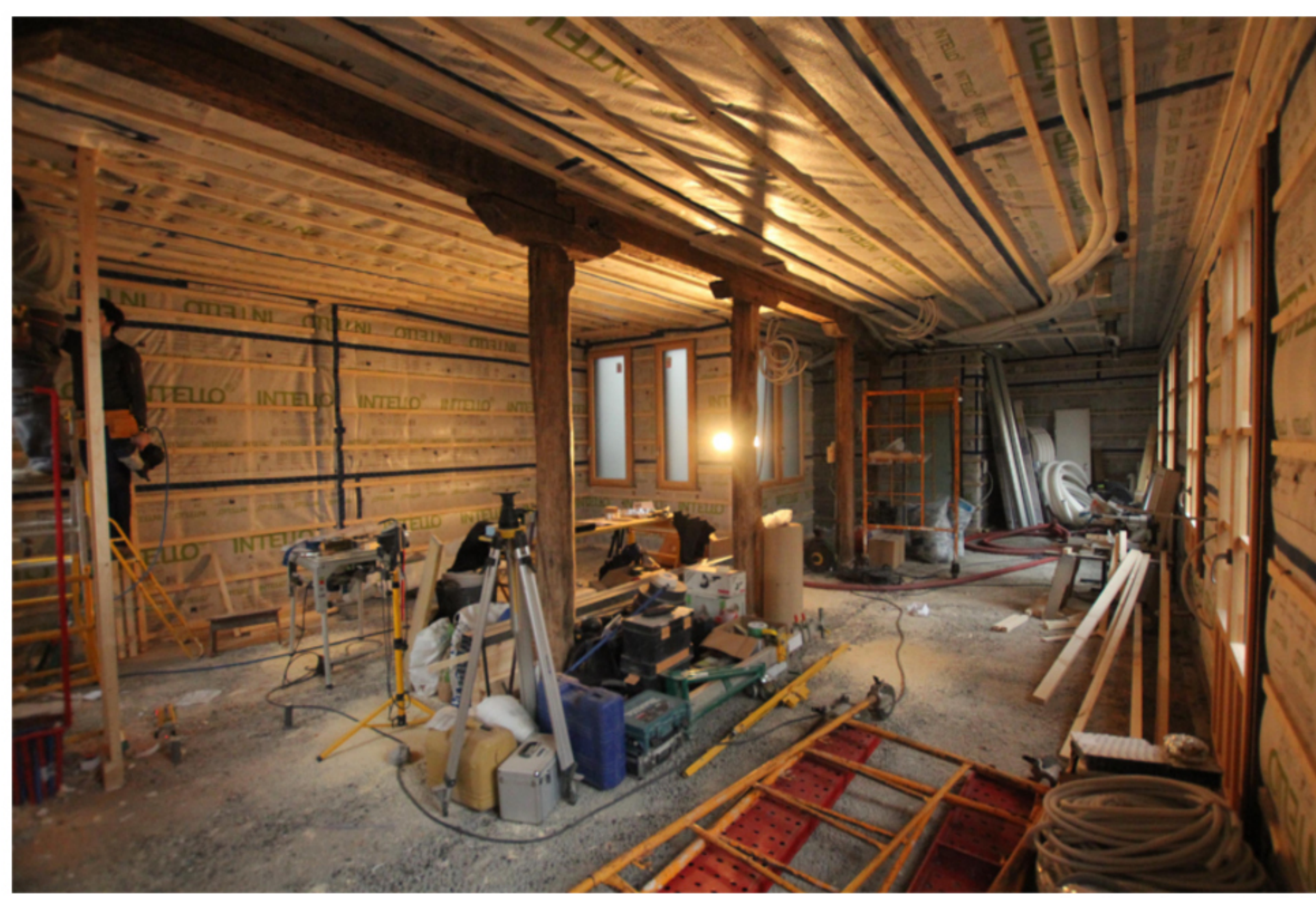
trasdosado de aislamiento
