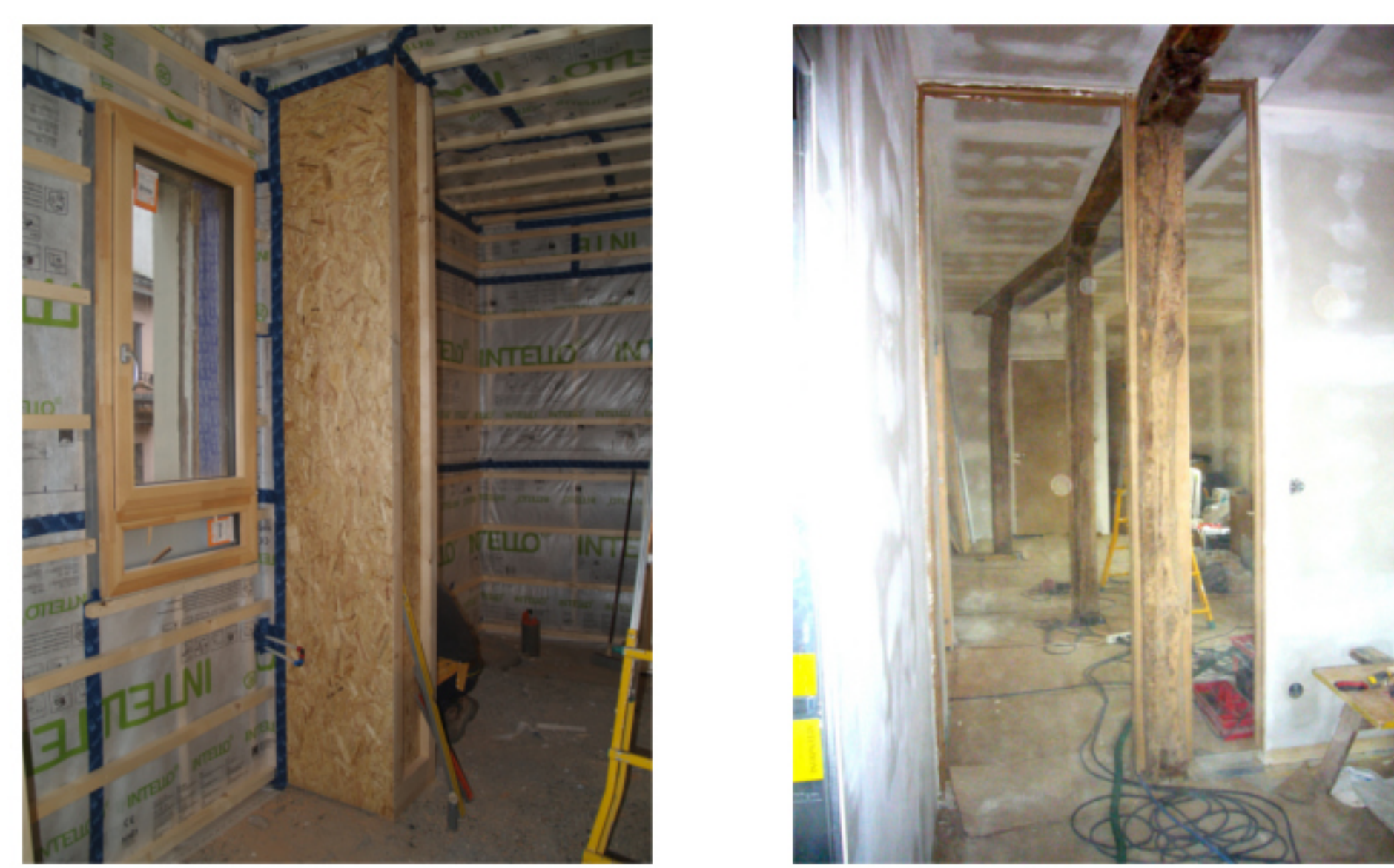
Cajón de caldera
